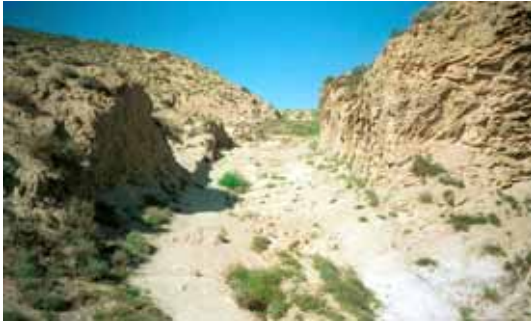
Trinchera excavada en yesos para la Vía de Calagurris (Calahorra) a Pompaelona (Pamplona), en Azagra (Navarra).
