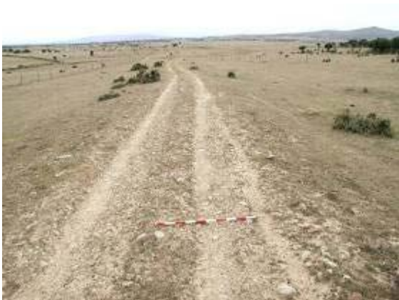
Aspecto del terraplén de la Vía de la Plata con indicios de reparaciones.
