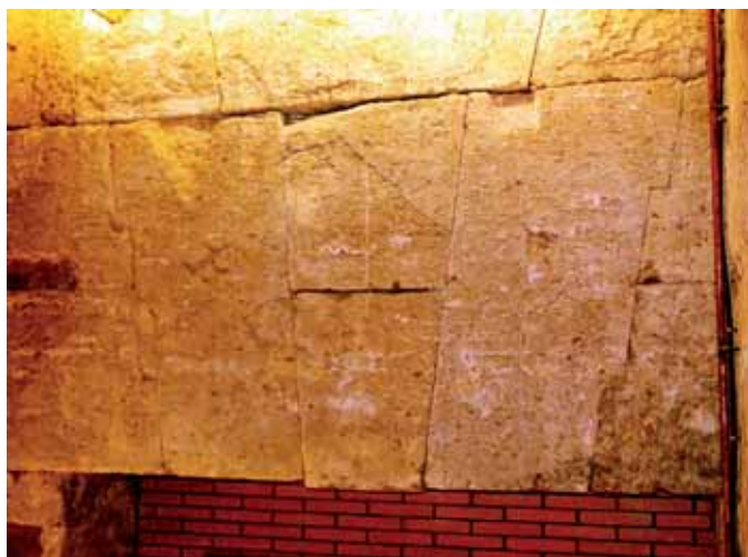
Fig. 19. Dintel adovelado con engatillado en Tarraco.
