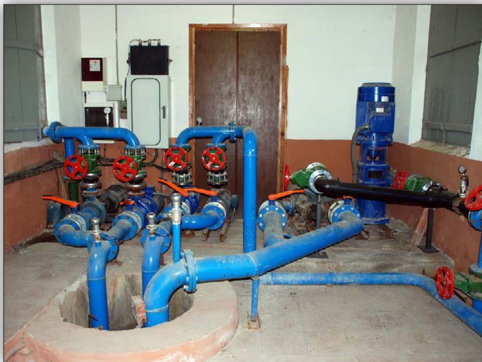
Grupo de bombas de la captación del abastecimiento a Albarracín aprovechando los caudales del manantial que abasteció al acueducto romano a Cella.
