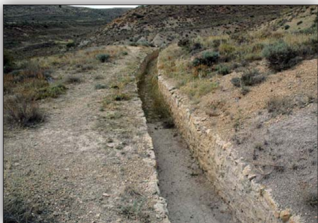
Canal en obra de fábrica en la zona anterior al gran túnel.
