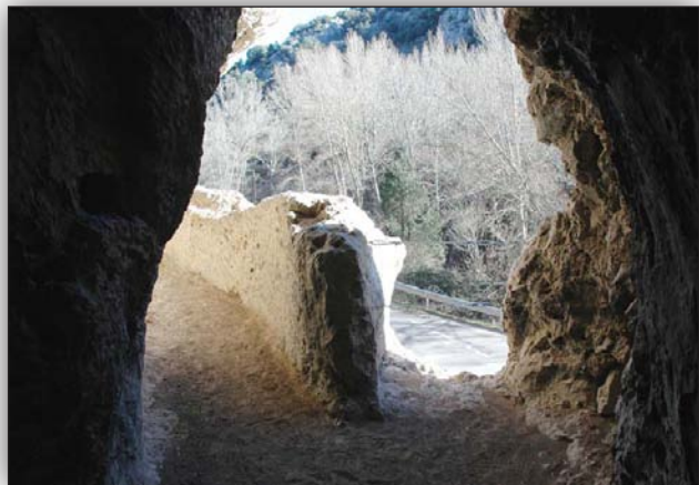
Aliviadero a la salida del túnel sobre la carretera de Gea a Albarracín. Probable tramo destruido por desprendimientos y restituído en vida del acueducto.
