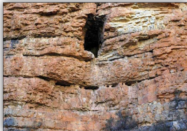
Depósitos calcáreos procedentes de filtraciones del canal, bajo otro de los registros en forma de ventana en el barranco de los Burros.
