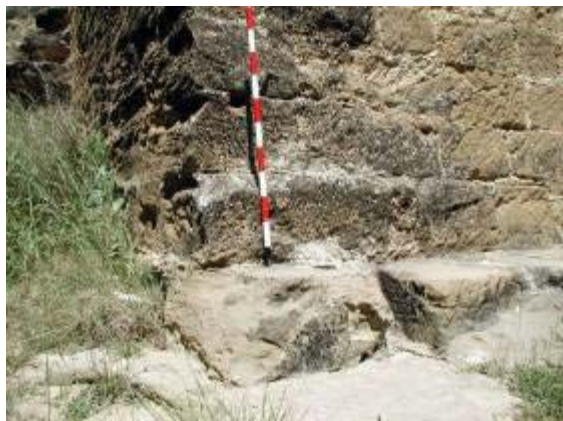
Sillares de la primera hilada tallados en el propio sustrato rocoso y orificios de las grapas en las hiladas superiores.
