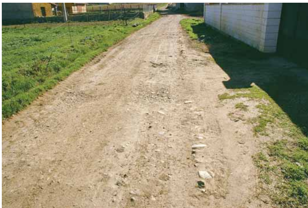
Fig. 23. Largo bordillo de la vía romana muy deteriorada, a la vista en 2004, en San Justo de la Vega.
