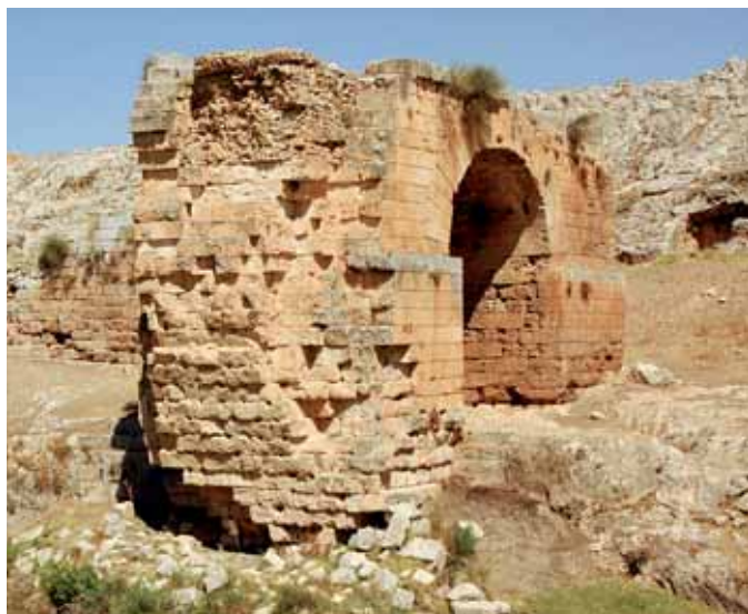
Fig. 13. Relleno interior de sillería y hormigón de cal aérea en el puente Göksu (Turquía).
