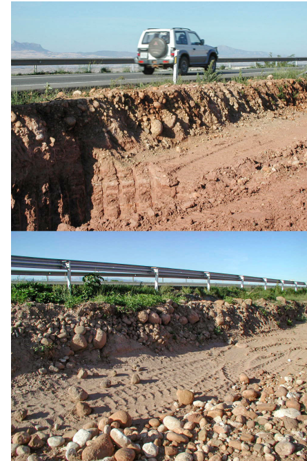
La vía romana bajo la carretera N-120 en Navarrete antes de ser desmontada.
