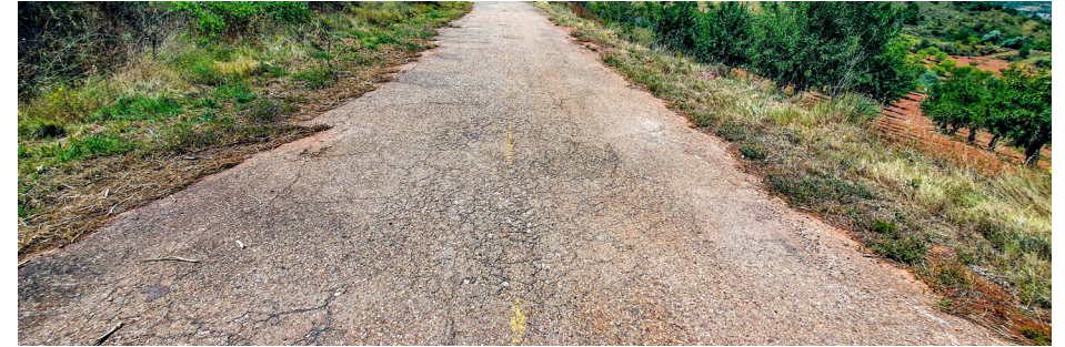
Tramo abandonado y en desuso, pero fácilmente rehabilitable para usos lúdicos, de la antigua N-II en el Frasno (Zaragoza). Se observa aún la primitiva señalización horizontal en amarillo y conserva casi todo el bordillo laterales en piedra negra de Calatorao.
