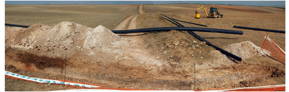
La vía romana de Italia a Hispania seccionada sin miramientos ni control arqueológico en Bañares de Rioja, en 2005, para el tendido de tuberías de riego. Se observa la cuneta de la antigua carretera romana cortada a la izquierda, en un color más oscuro.
