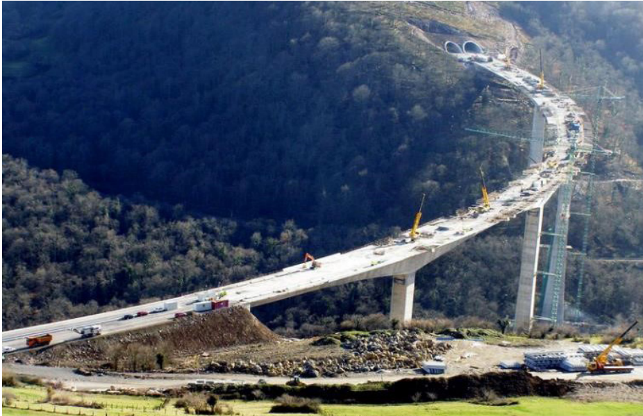
Aspecto del viaducto y del túnel cuya cota de ataque hubo que modificar en la autovía de la Meseta por la presencia del camino antiguo supuesto como romano, encareciendo con ello considerablemente las obras.
