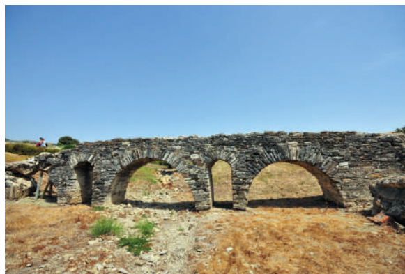
Fig. 58. Vista general de las pequeñas arquerías sobre el arroyo Chorrea, en Baelo Claudia (Cádiz). La geometría de la estructura en general y los aparejos, son de una mediocridad evidente.
