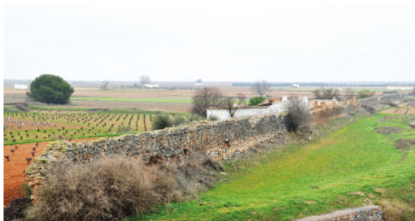
Fig. 48. Vista general del paredón de mal hormigón, que forma la presa de Consuegra en los tramos extremos. Tramo sin contrafuertes.
