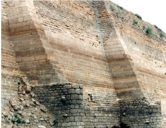
Fig. 43. Paramento de aguas arriba de la presa de Proserpina. En él, se distinguen fábricas muy diferentes, peores y menos "romanas" cuanto más abajo. Foto: Tomás Porro.
