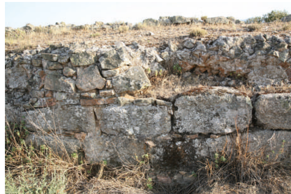
Fig. 46. Parte de los paramentos constructivamente más pobres de la presa de Alcantarilla. Foto: C. Blázquez.
