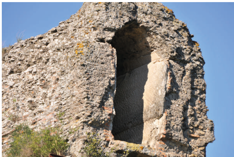
Fig. 8. Concreción calcárea repicada para restablecer la sección del acueducto del Anio Novus , cerca de Castell Madama, en el Lacio (Italia).
