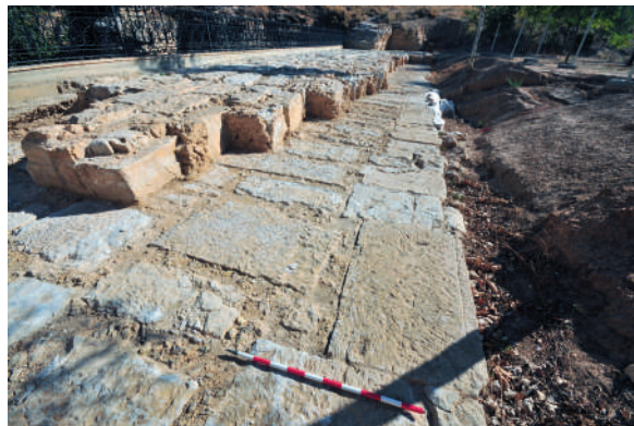
Fig. 37. Vista superior del cuerpo de la presa de Muel, donde se observa el núcleo de sillares aglomerados con hormigón de calicanto y el forro exterior de aguas arriba con las juntas cerradas y a hueso.
