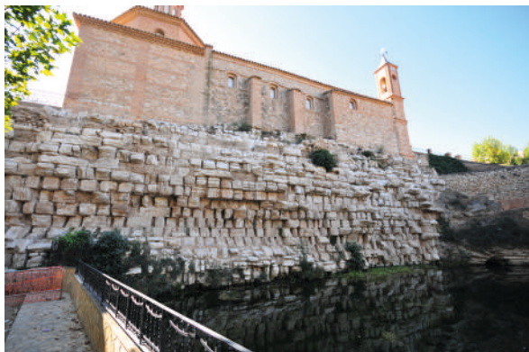
Fig. 36. Vista general del paramento de aguas debajo de la presa de Muel. La parte superior conserva los sillares del forro exterior a hueso con las juntas verticales cerradas. La inferior ha perdido el revestimiento exterior y se observan las juntas verticales abiertas que quedaron rellenas con el hormigón del núcleo de la presa.
