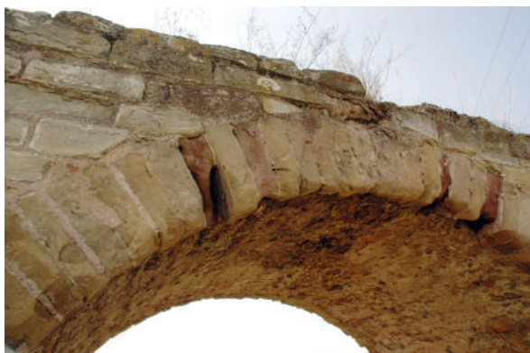
Fig. 57. Detalle de un arco del acueducto de Alcanadre. No solo la fábrica es deficiente, la calidad de la piedra es también mala. Éste, es el único arco original que se mantiene sin reconstruir, aunque ya rejuntado.
