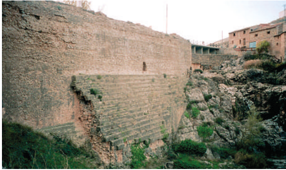
Fig. 33. Vista desde aguas debajo de la presa de Almonacid de la Cuba (Zaragoza), dispuesta aprovechando el encajonamiento del río Aguasvivas.
