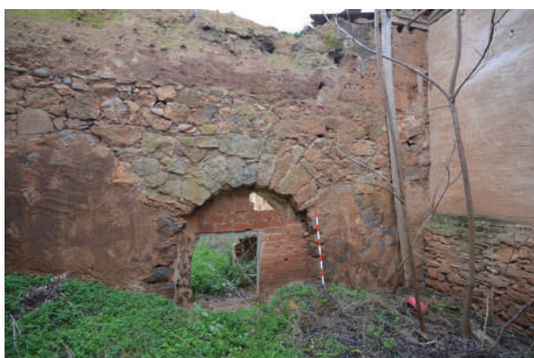
Fig. 59. Uno de los últimos arcos supervivientes del acueducto de Consuegra donde se puede apreciar su fábrica impropia de los opus romanos. Existe una foto de un conjunto de arquerías supervivientes en el siglo XX, que se cayeron solas.
