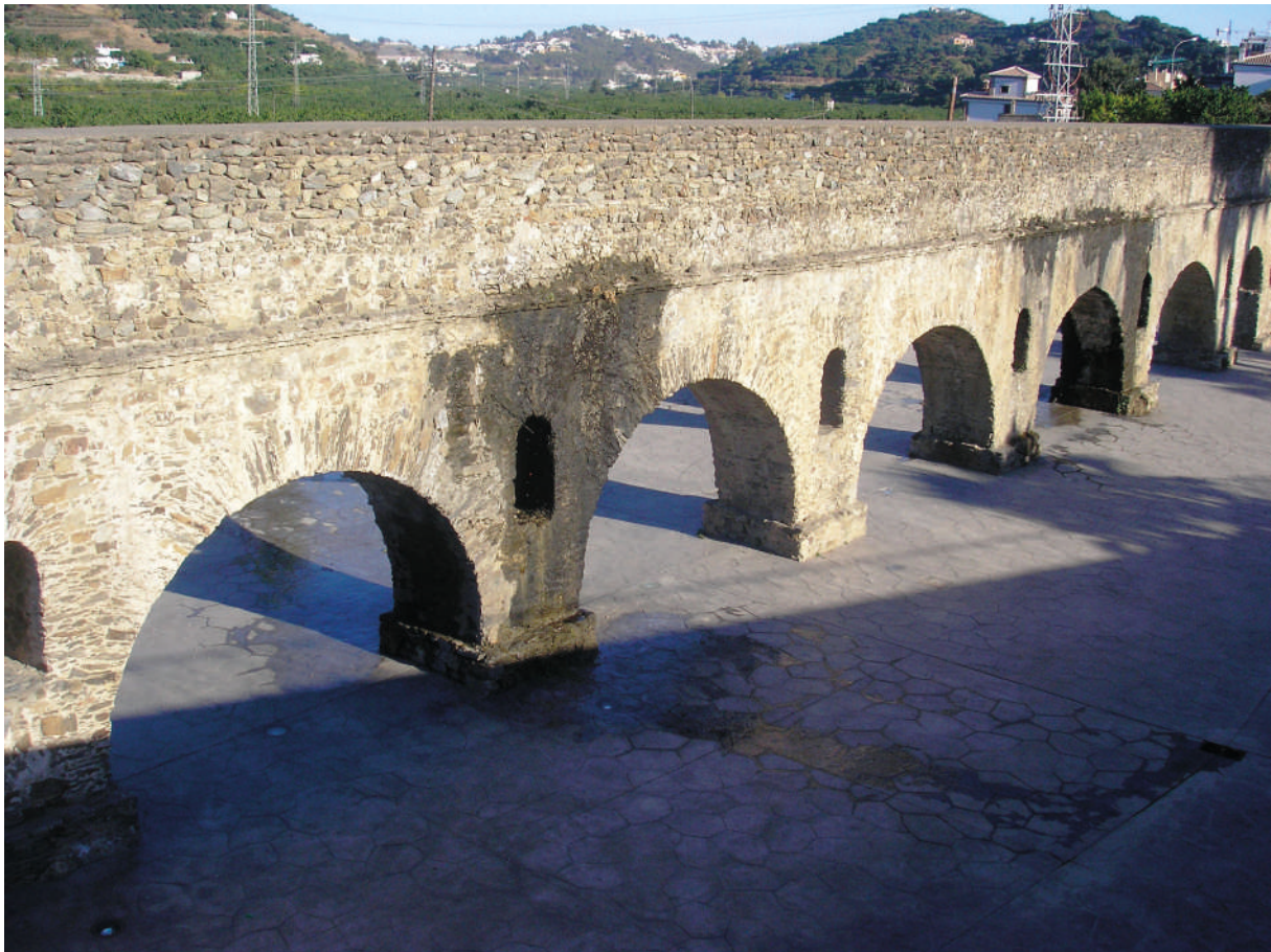
Fig. 5. Pérdidas de agua en el acueducto de Almuñécar.
