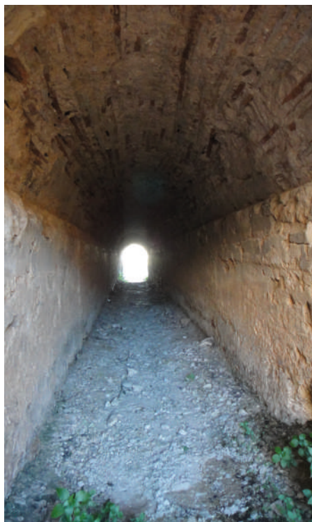
Fig. 11. Bóveda de la atarjea del aljibe IV en su discurrir a la taberna 4, con sus apoyos para la cimbra. Apoyos de funcionalidad similar al supuesto especum de la galería. Fotografía del autor.
